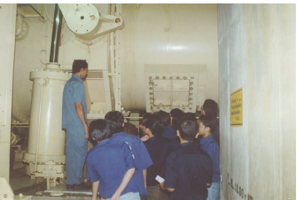
ท่อทางน้ำเข้าสู่กังหันปั่นไฟฟ้าได้เขื่อนบางลาง
